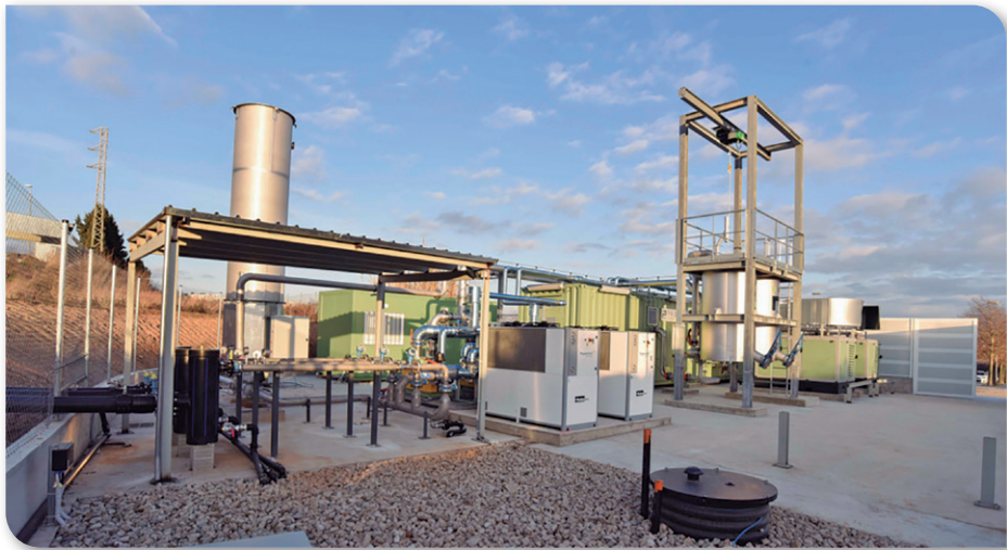
Planta de gas renovable en el Parc de l'Alba de Naturgy
