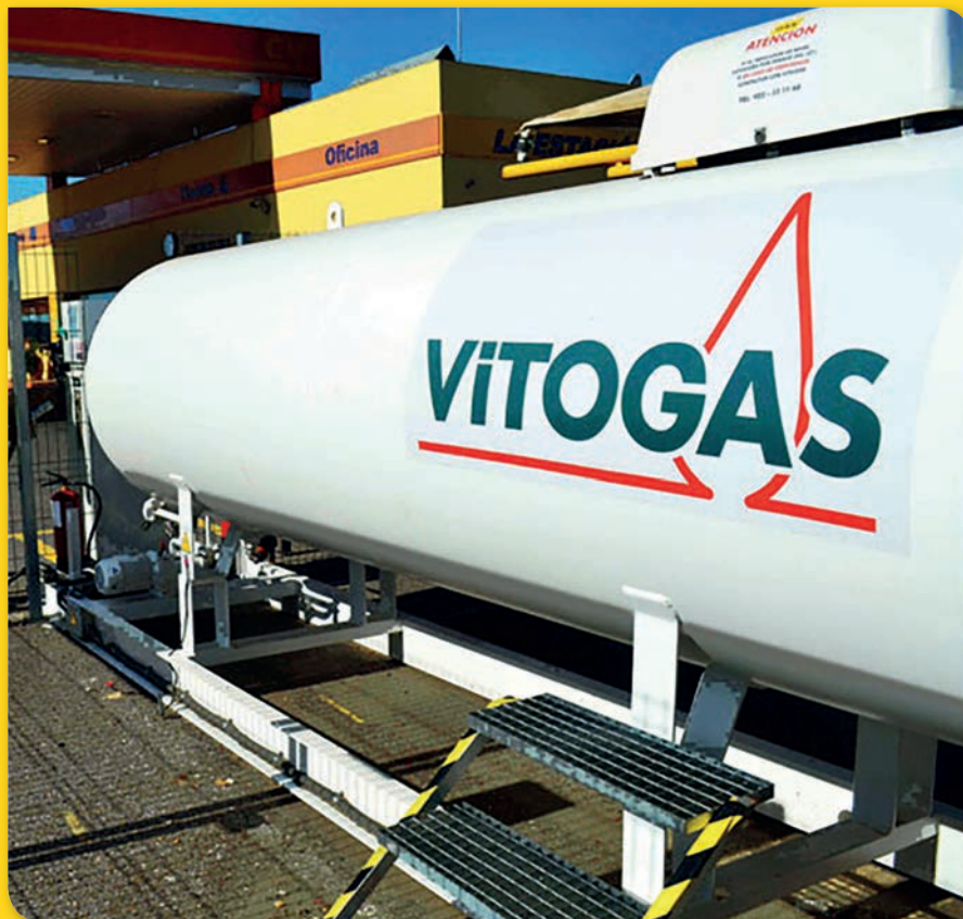
Instalación de Autogás de Vitogas en el área de servicio de La Estación
