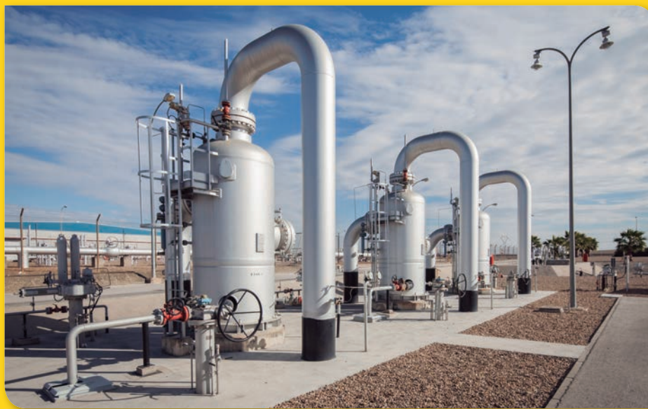
Estación de Compresión de Dos Hermanas de Enagás
