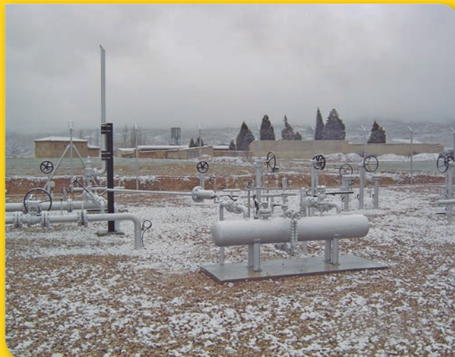
Gasoducto de Endesa
