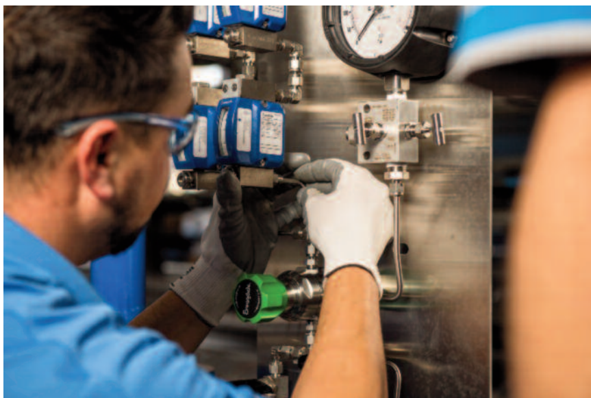
La disposición de los componentes del sistema auxiliar al sello en un panel ayuda a los operarios a identificar mejor los componentes, confirmar su correcto funcionamiento y realizar el mantenimiento.
