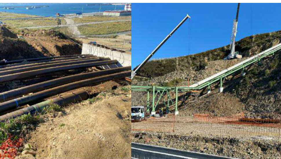
Entrada de poliducto a puerto (1)
