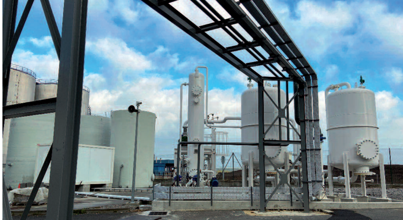
Unidad recuperación de vapores URV
